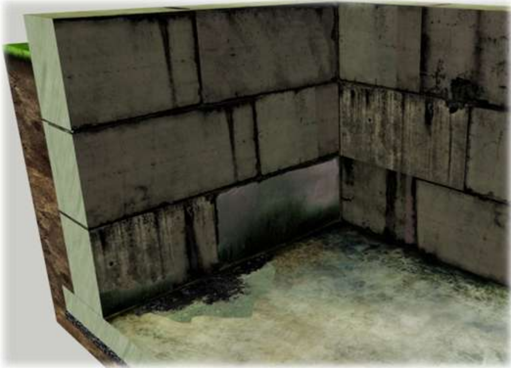
Рис. 1. Стена из блоков. Блоки намокли, швы текут.
